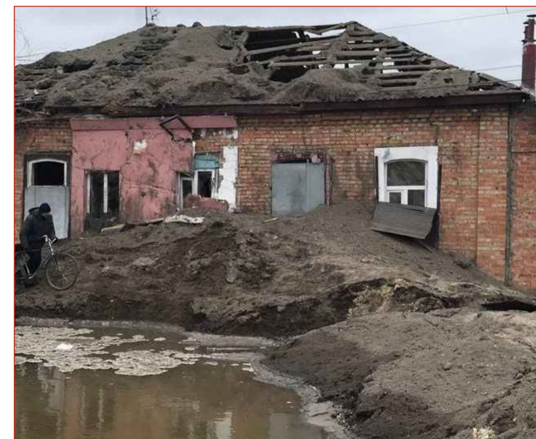
Приклад пошкодження будівлі та території навколо
