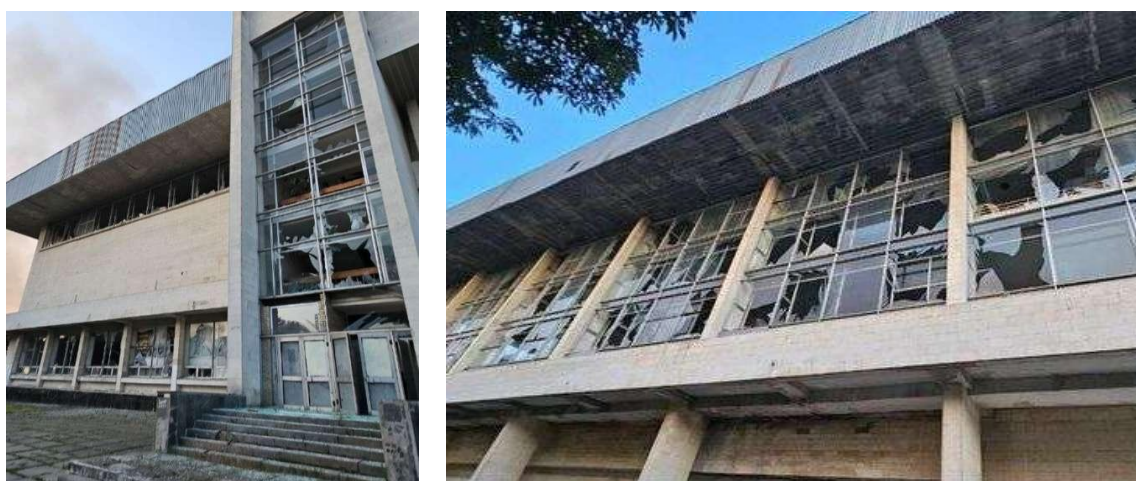
Рис. 2.1.4 Наслідки обстрілу по Києву [4]
