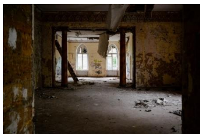
Додаток 20 Фотофіксація пошкоджень на Дачі Анатра: Колони, другий поверх [Приватний фото архів власників]
