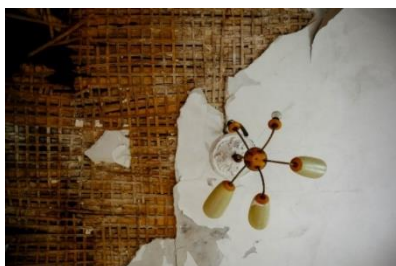
Додаток 19 Фотофіксація пошкоджень на Дачі Анатра: Міжповерхове перекриття [Приватний фото архів власників]
