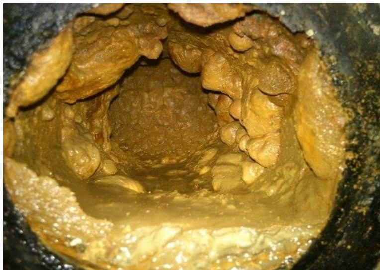
Рис. 3. Фрагмент сталевго водопроводу внутрішня поверхня якого деформована внаслідок процесів корозії та біологічного заростання [8]
