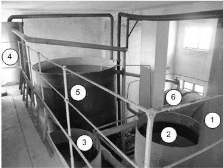
Рис. 4. – Загальний вигляд на фільтри:
