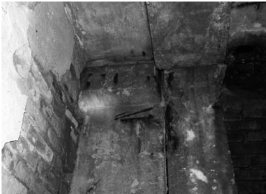
Рис. 2. Біопшкодження в виробничому приміщенні
