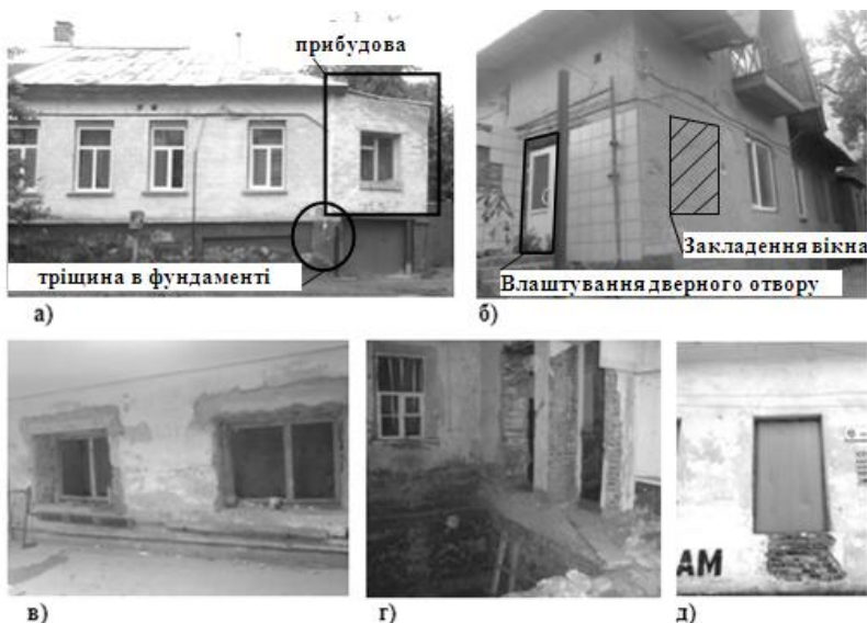
Рис. 1. «Неправильні» дії власників будинків, що призвели до деформації будинків в м. Чернігові: а) добудова, що викликала деформацію фундаменту; б) перепланування з закладанням вікна та влаштуванням входу з порушенням норм; в) вирубування вікон в стіні підвалу; г) утворення допоміжних дверних отворів в несучій стіні та виймання ґрунту для влаштування підвалу; д) під час виймання ґрунту біля фундаменту почала деформуватися стіна
