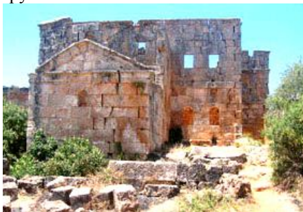
Рис.2. Вертикальні тріщини в будівлі мертвого міста Серджилла
