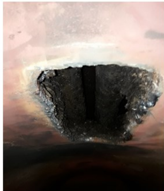
Рис. 5. Котел Riello RTQ-953 з вирізаною зоною перегріву
