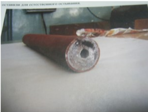
Рис. 8. Стан труби з котла ПТВМ-30 перед промивкою
