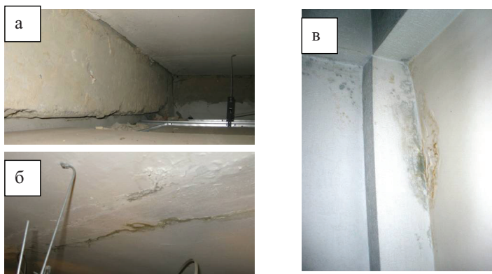
Рис. 2. Руйнування та випадіння швів між плитами та поздовжнім ригелем (а), сліди замокання панелей покриття (б), зволоження зовнішньої огороджувальної конструкції (в).
