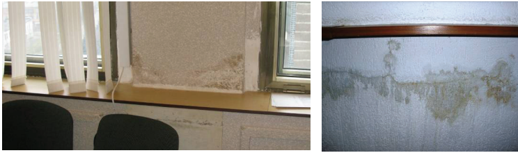
Рис. 3. Замокання стінових панелей у місцях встановлення віконних рам.
