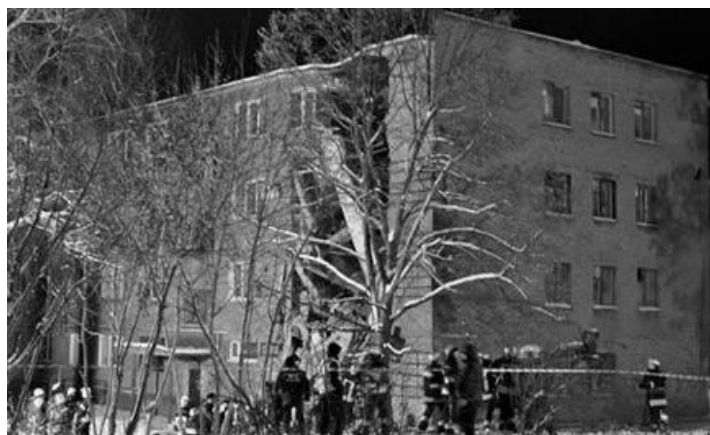
Рис. 1. Обрушення плит перекриття житлового будинку в м. Чернігів
