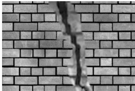
Рис. 1 Представлення тріщини на цегляній поверхні
