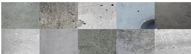
Рис.5: Фото без тріщин..
