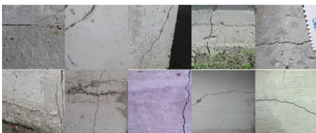
Рис.4: Фото з тріщинами.
