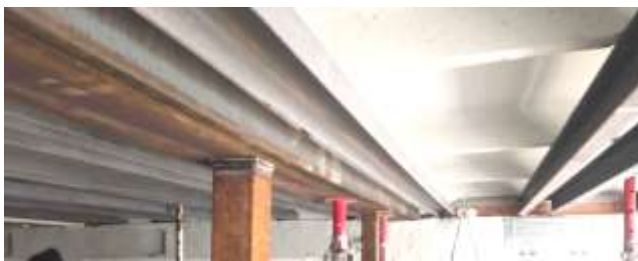
Рисунок 4. Монтаж металевих елементів підсилення під пошкоджені плити покриття при ліквідації прогинів домкратами.
