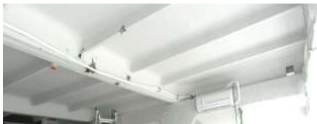
Рисунок 1. Загальний вигляд та стан пошкоджених збірних ребристих залізобетонних плит покриття
