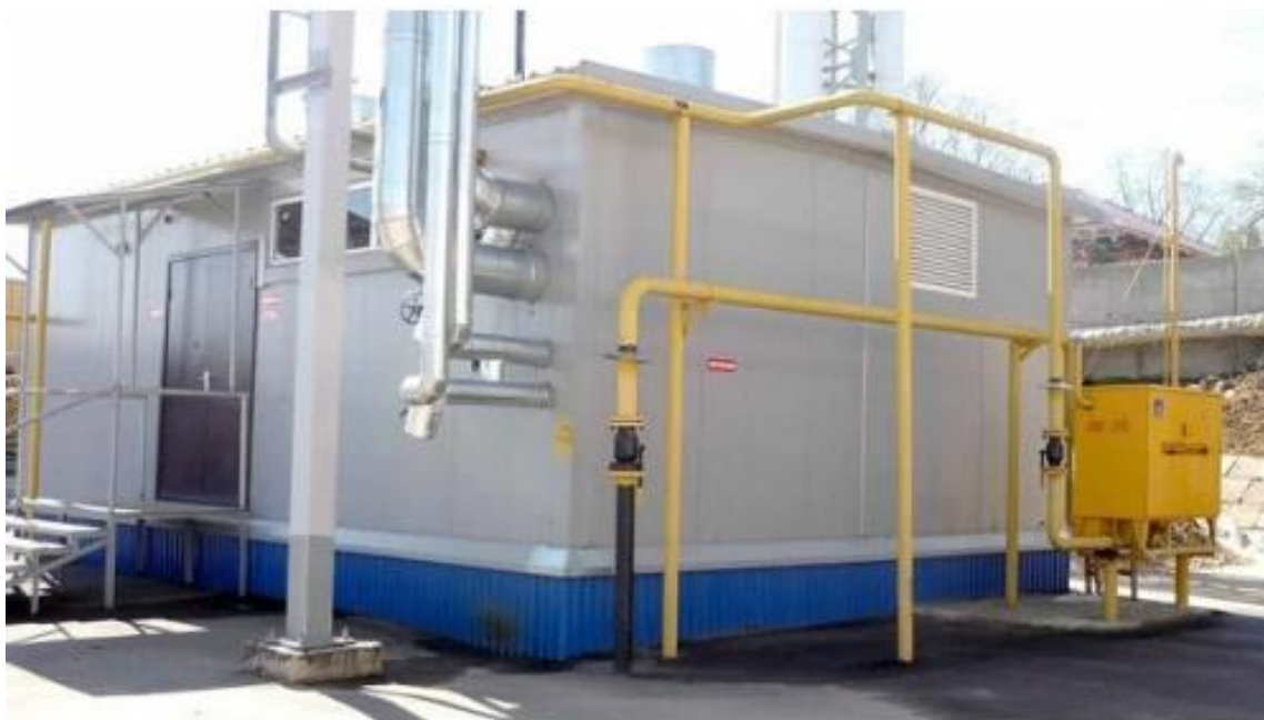
Рис.1.3 Зовнішній вигляд модульної котельні
