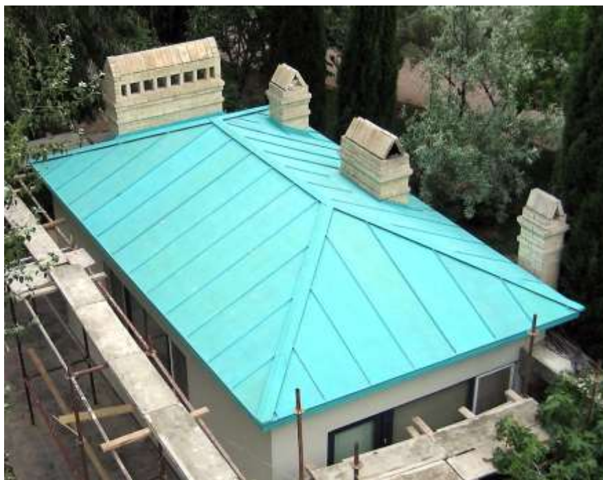
Рис. 141. Покрівля з металевих листів за рулонною технологією вальмового покриття житлового одноквартирного будинку
