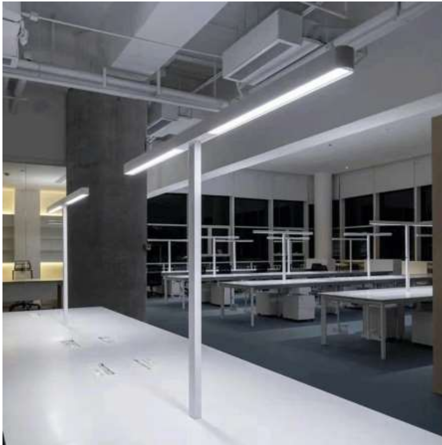
Рис. 2.2.2. Приклад освітлення на фабриках.
