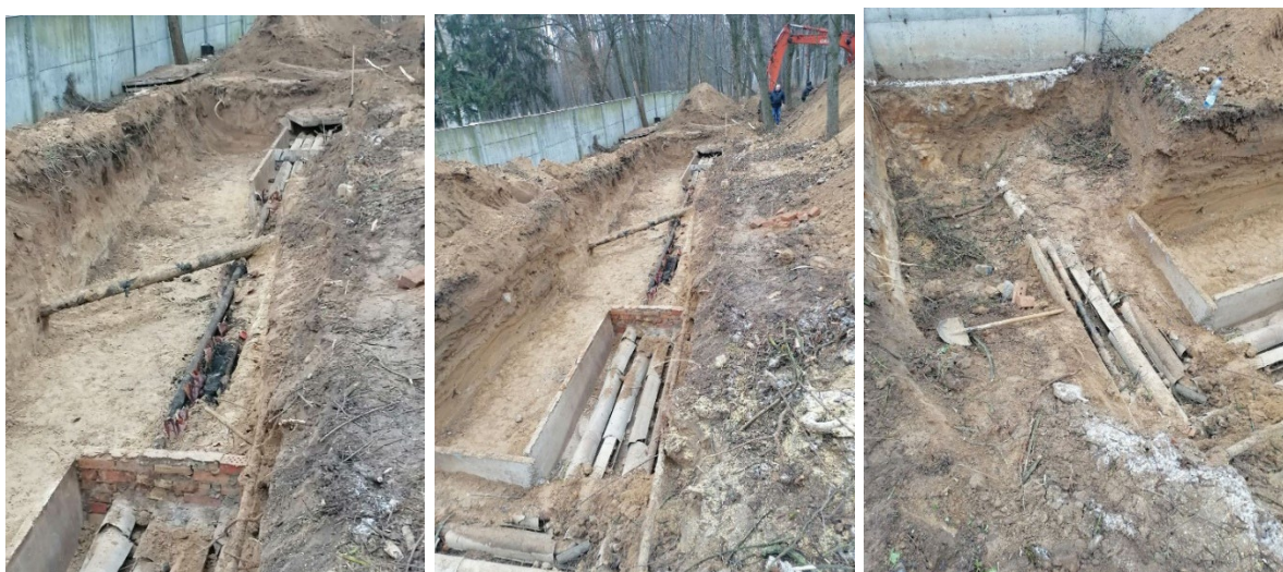
Рис. 1.2.3. Відкриті ділянки теплової мережі перед демонтажем. Загальний вигляд трубопроводу в зоні корозії
