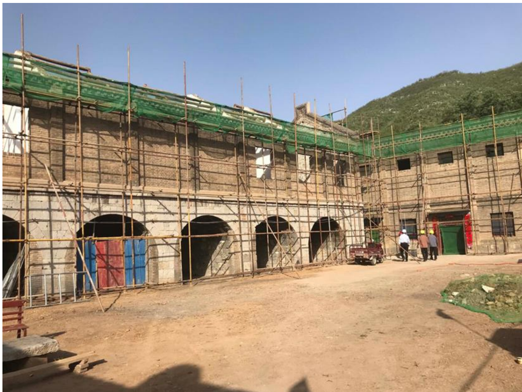
Рис 1.2.11. Вигляд до ремонту [11]
