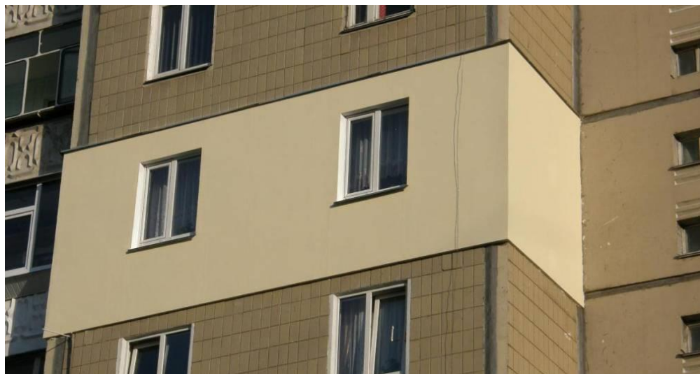
Рис. 6 Поганий приклад утеплення, який може призвести до появи плісняви, грибку і тріщин у стінах. []
