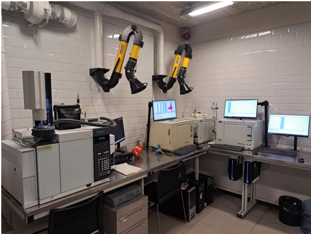
Рис. 5.1. Загальний вигляд Лабораторії хроматографічного аналізу Управління аварійно-відновлювальних робіт АТ «Київгаз».
