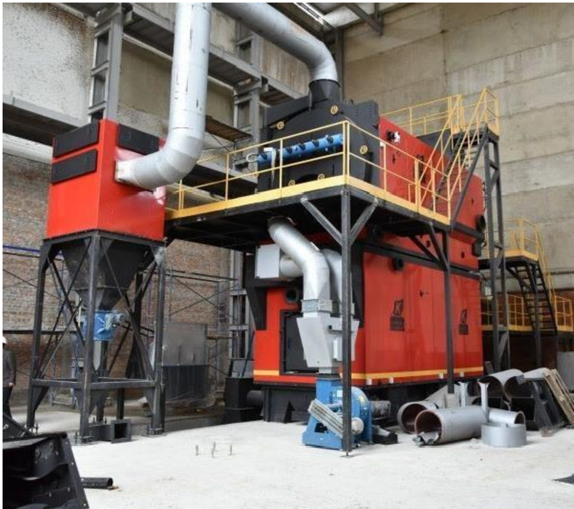
Рис 1.1 Котельня з обладнанням
