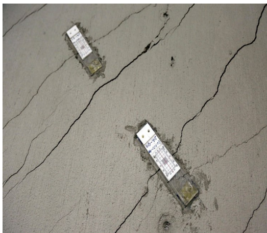
Рис. 7. Тріщини в стінах з встановленими датчиками їх розширення
