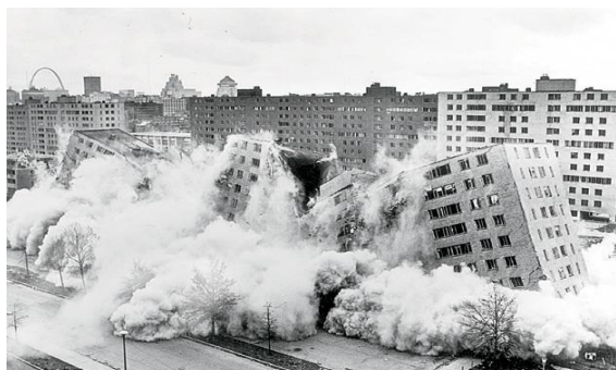
Рис.2 Снос района Прюит-Игоу в Сент-Луисе, состоявший из 33 одиннадцатиэтажных домов. На этом история многоэтажных жилых микрорайонов в США была завершена.
