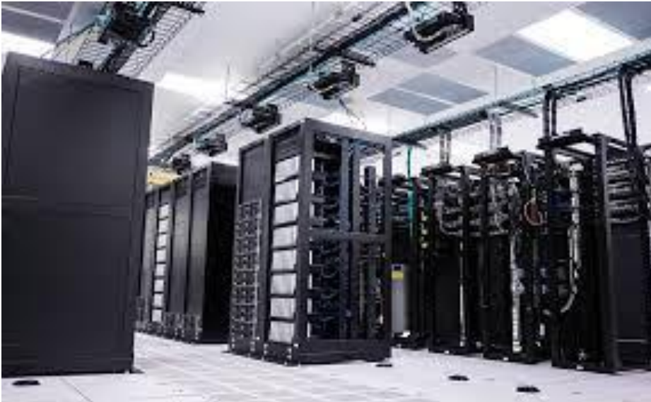
Рис. 2.11. Оснащення серверної кімнати.
