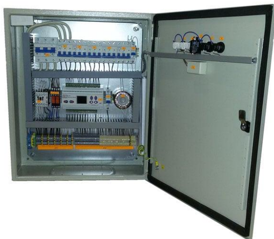
Рис.6.18. Шафа керування вентиляцією
