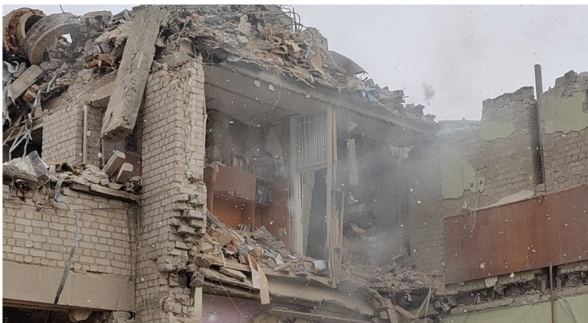
Рис.3.1. Фото зруйнованого фрагменту школи
