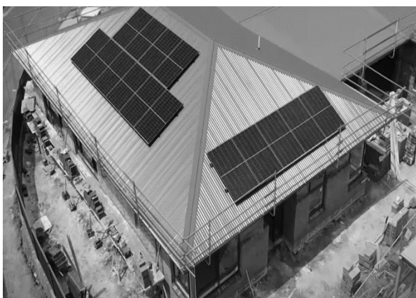
Рисунок 1. Використання елементів кріпильних систем для захисту від падіння при монтажі сонячного енергопостачання
