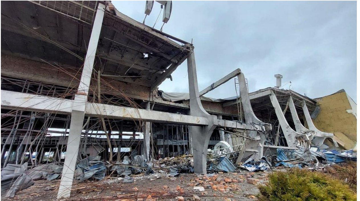
Рис. 1.1. Фото зруйнованого терміналу аеропорту ‘Миколаїв’[1]
