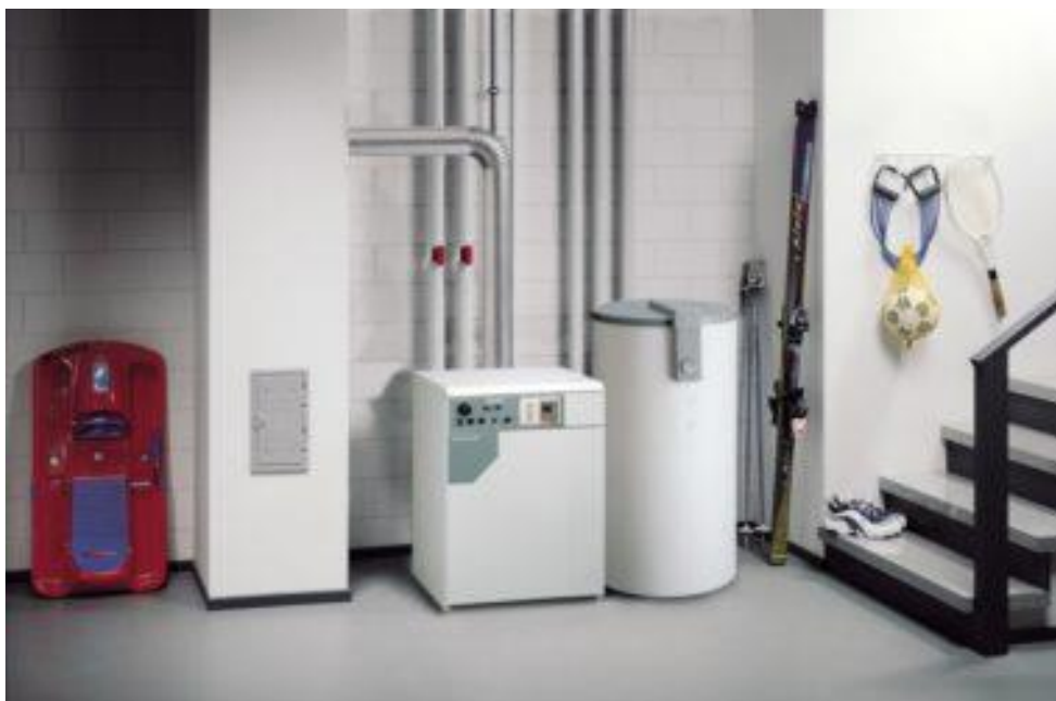
Рис 7.1.2. Зображення котельні в технічному приміщенні
