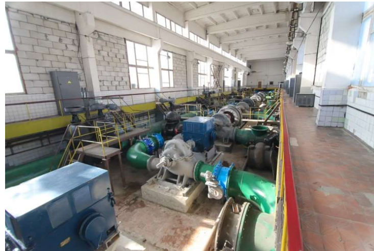
Рис.1.6. Питну воду у мережу водопроводу подають насоси, встановлені в машинній залі
