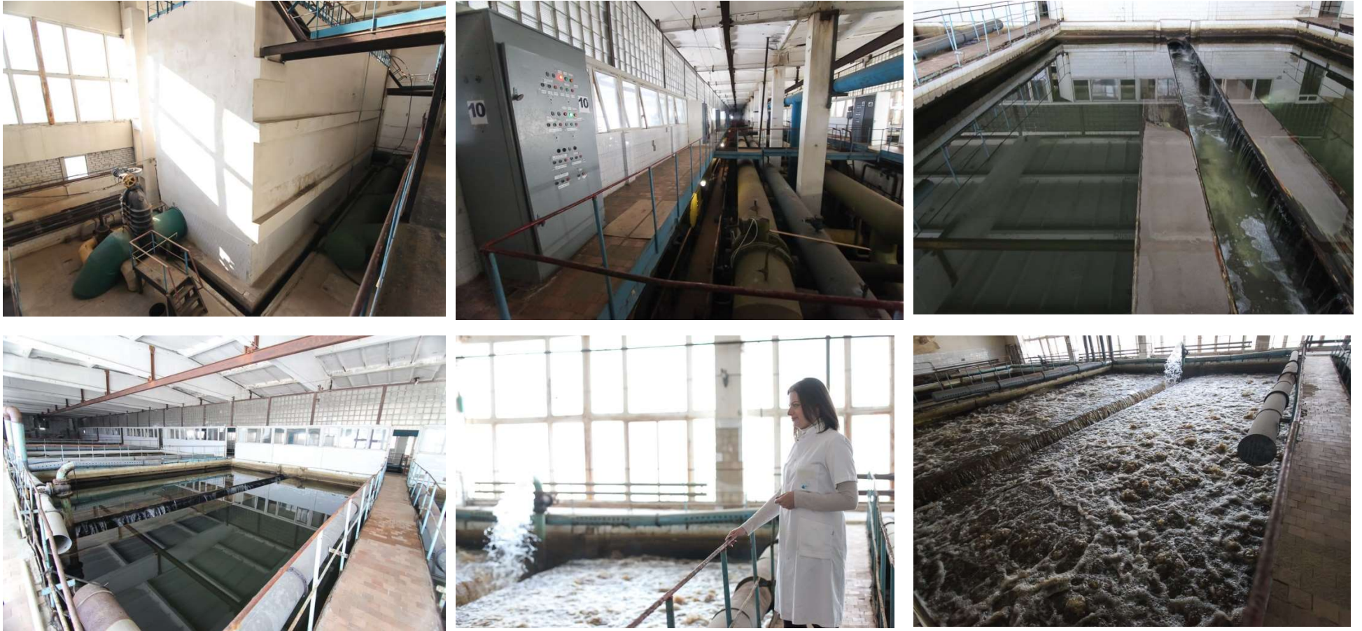
Рис.1.3. Резервуар чистої води
