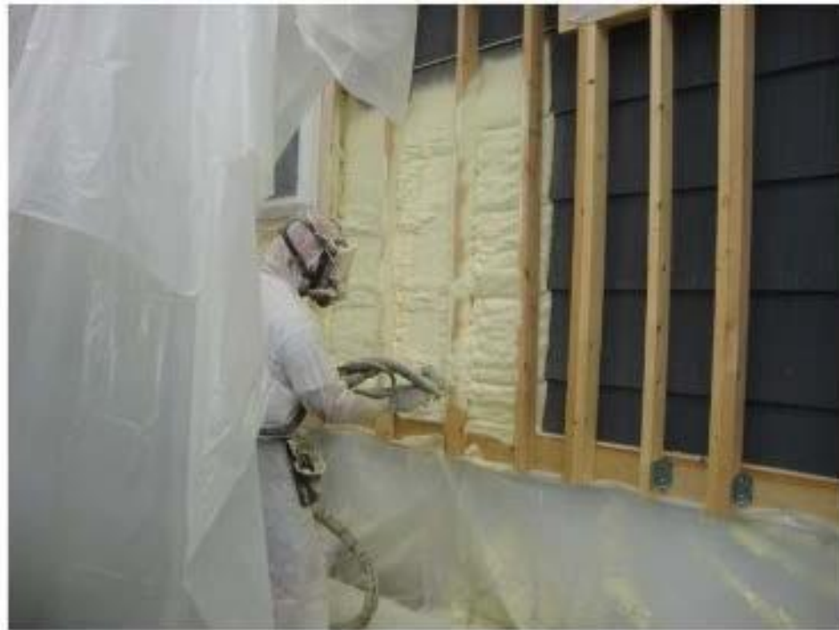
Рисунок 6. Напилювана піна, встановлена між стійками в новому каркасі, зведеному поверх існуючого сайдингу (IBACOS 2013б)
