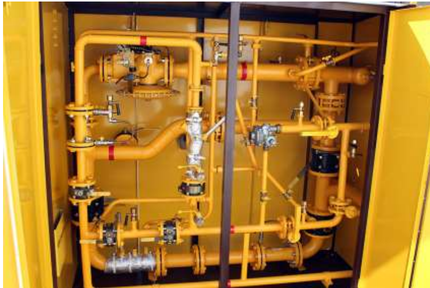
Рис. 2. Шафовий газорегуляторний пункт (ШГРП)
