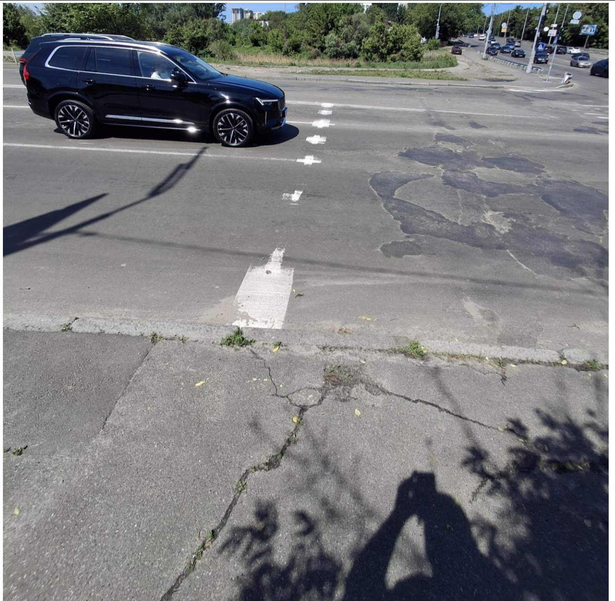
Рис 1.1.4 Фото існуючого стану дорожнього покриття
