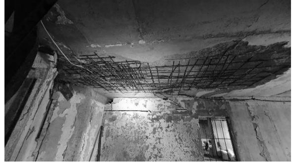
Рисунок 2 Наслідки тривалої дії вогню на монолітне залізобетонне перекриття.
