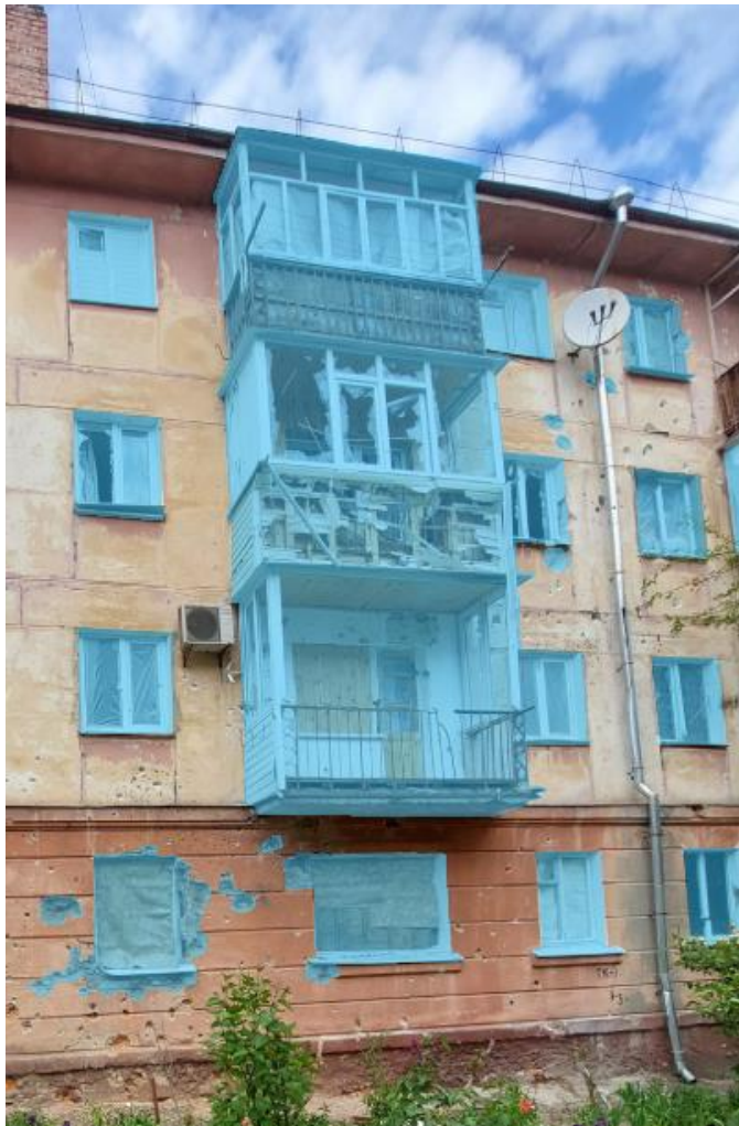
Рис. 2.1.1. Перший ступінь пошкоджень будівлі.
