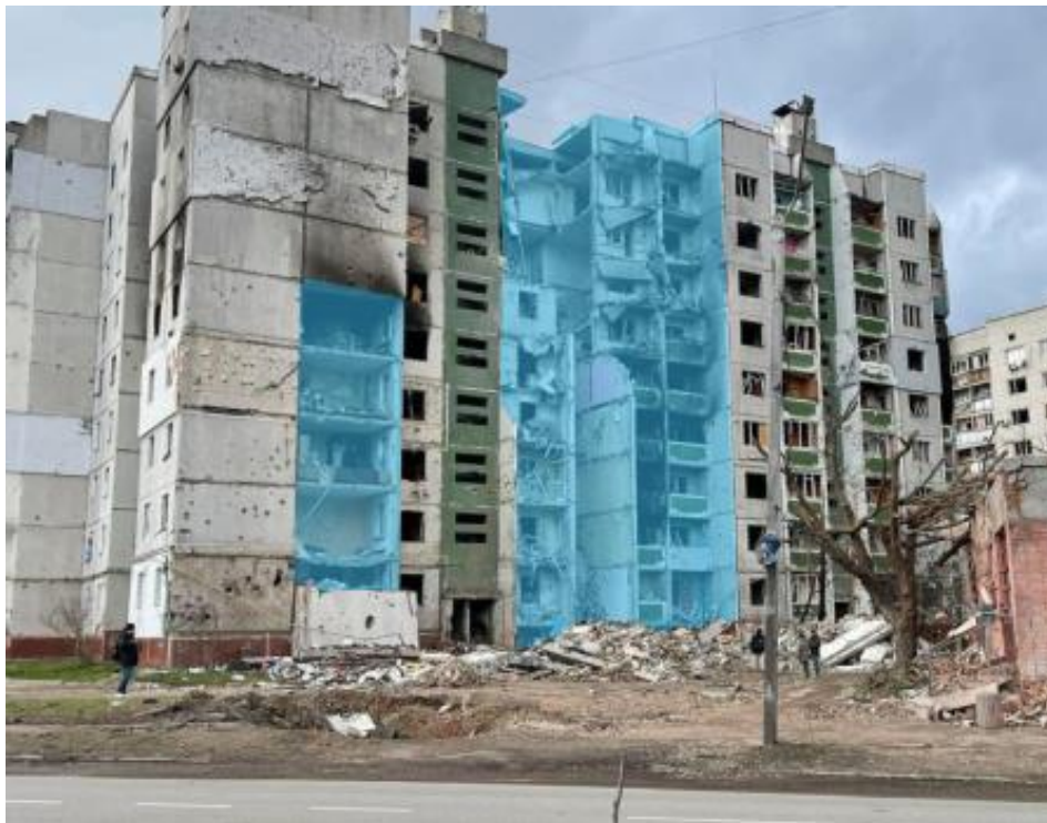
Рис. 2.1.3. Третій ступінь пошкоджень будівлі.
