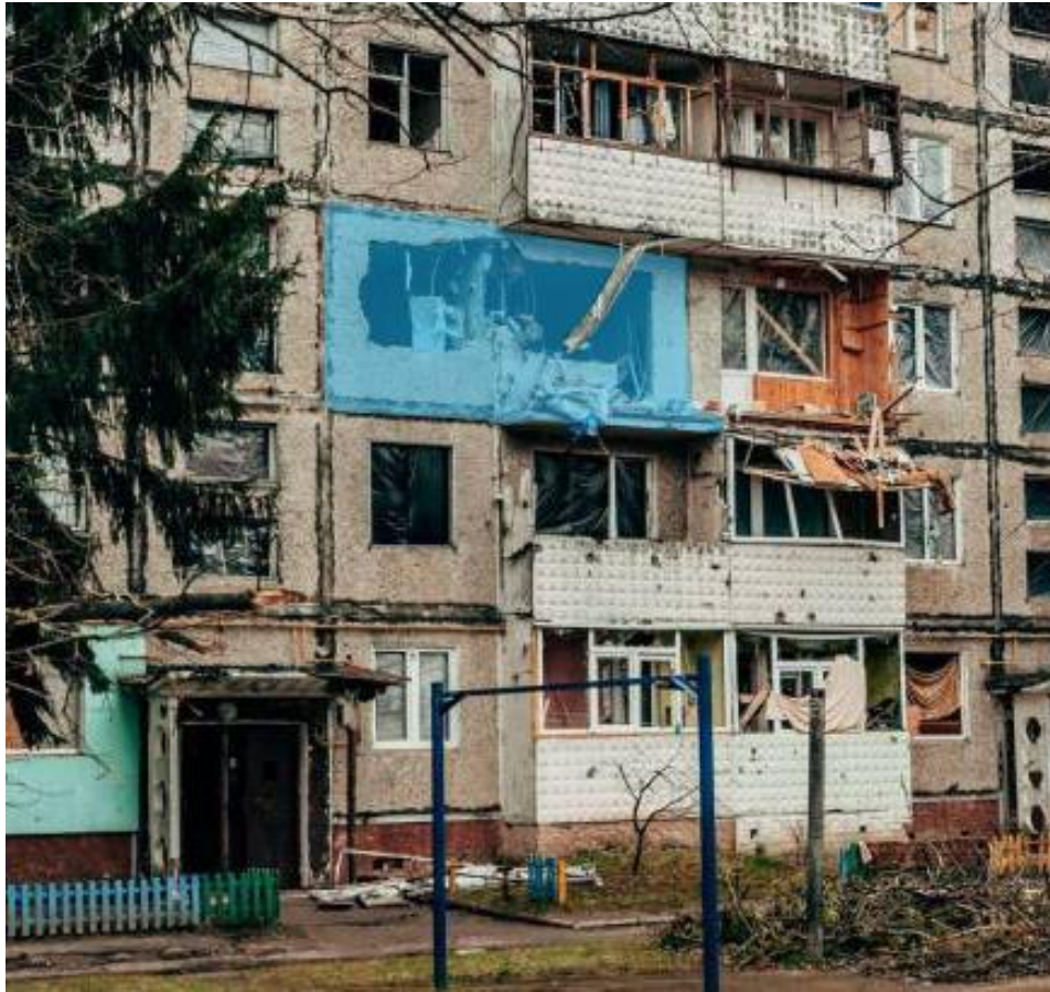
Рис. 2.1.2. Другий ступінь пошкоджень будівлі.
