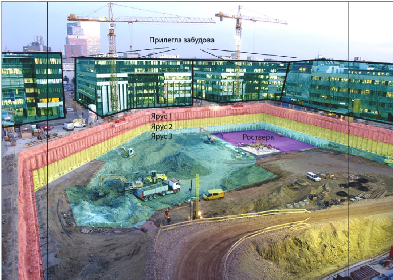
Рис. 2. Спорудження блоку G торговельно-розважального центру Hugo Plaza з офісними приміщеннями різної поверховості (4 - 8 поверхів) та трьохрівневим підземним паркінгом в безпосередній близькості з існуючими будинками, Відень, Австрія.2006-2008 р
