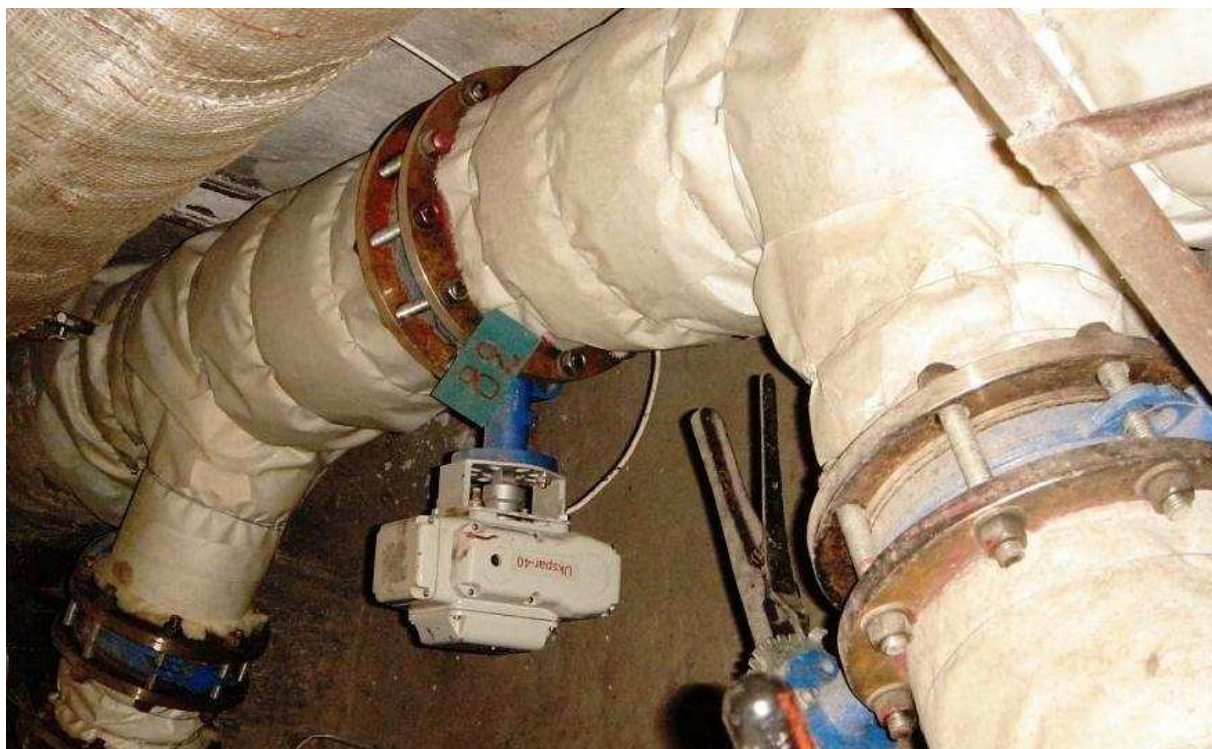
Рис. 3 Узел регулирования с косыми врезками и проходным регулирующим клапаном, установленный на ЦТП-6 в Коммунарском районе города Запорожье
