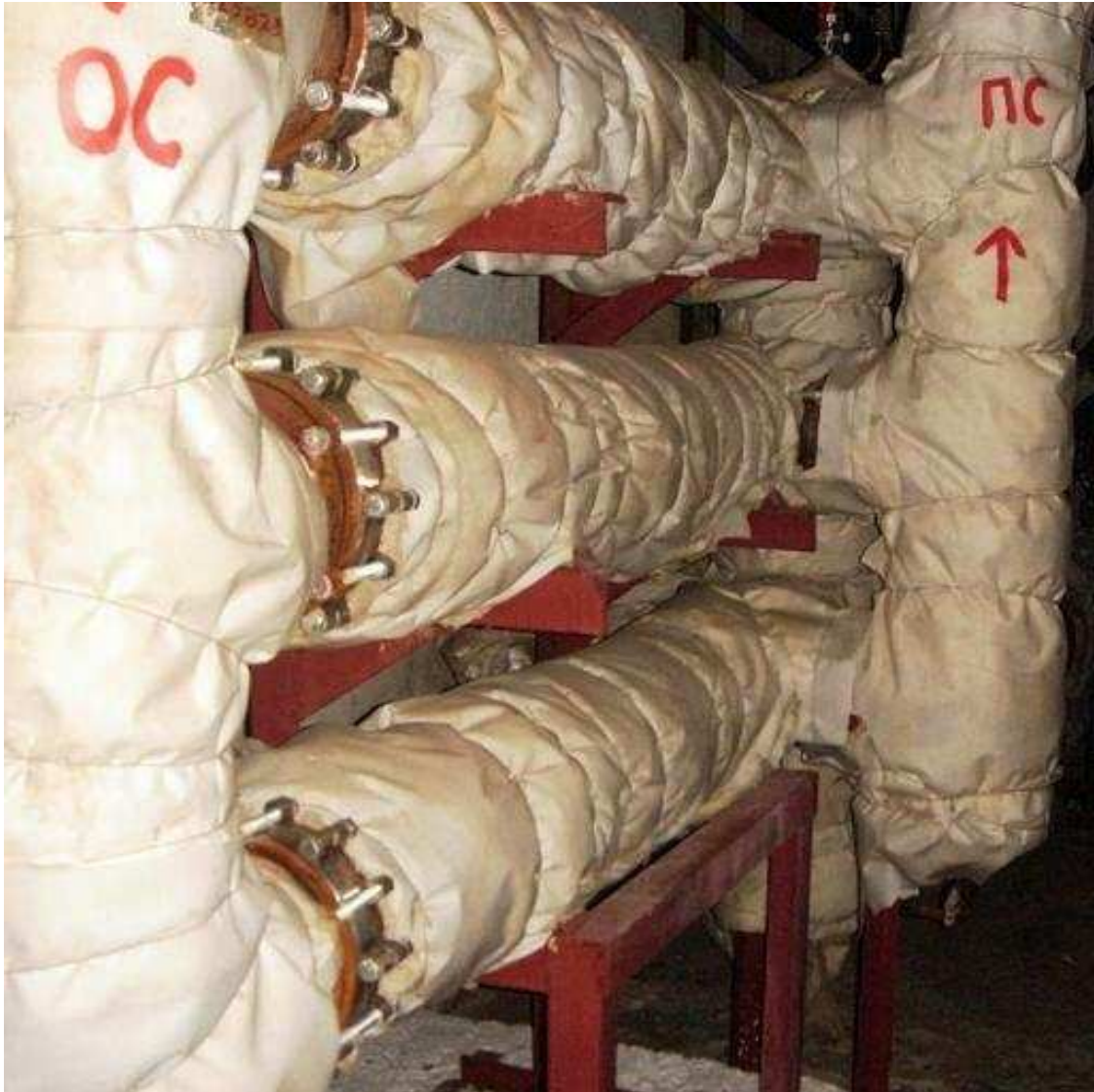
Рис. 4 Блок из трех интенсифицированных теплообменных аппаратов ТТАИ диаметром 200 мм и длиной 1500 мм в системе устойчивого регулирования ЦТП отопительной мощностью 16,8 Гкал/ч
