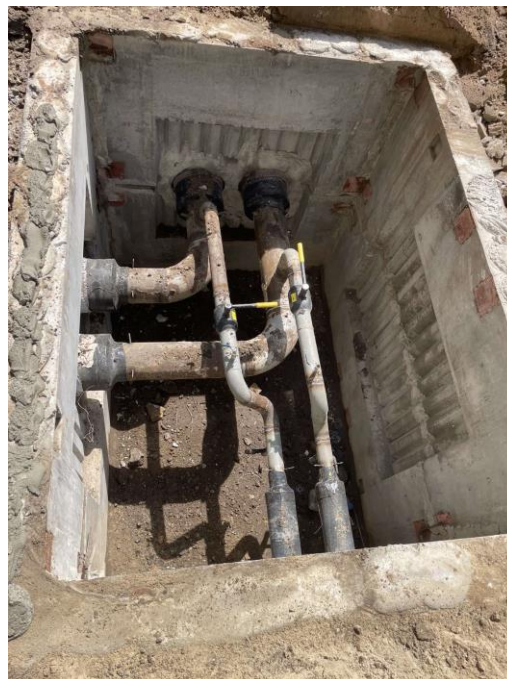
Рис.9. Труби та арматура в тепловій камері.
