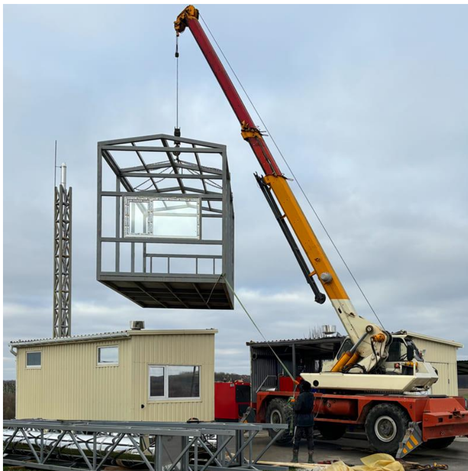
Рис. 4.5 Процес будівництва і монтажу твердопаливної транспортабельної котельні в с. Осолинка, Вінницької області.
