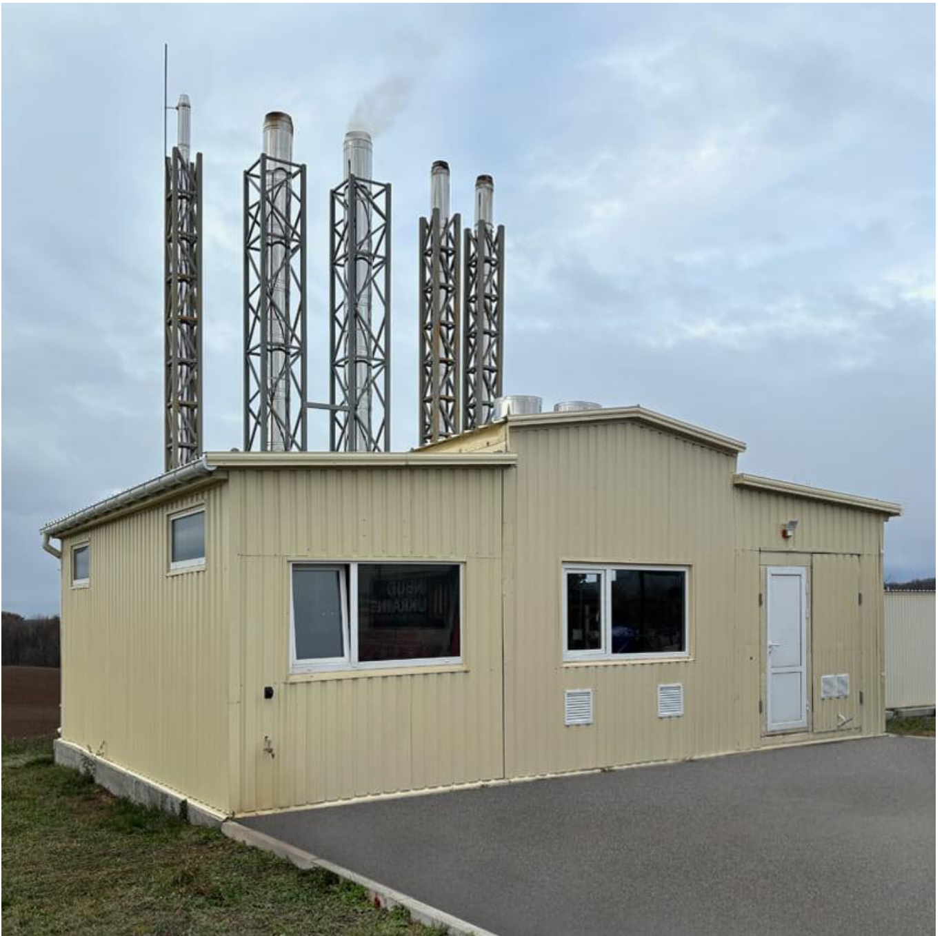
Рис. 4.3 Загальний вигляд і зовнішє опорядження твердопаливної транспортабельної котельні в с. Осолинка, Вінницької області.
