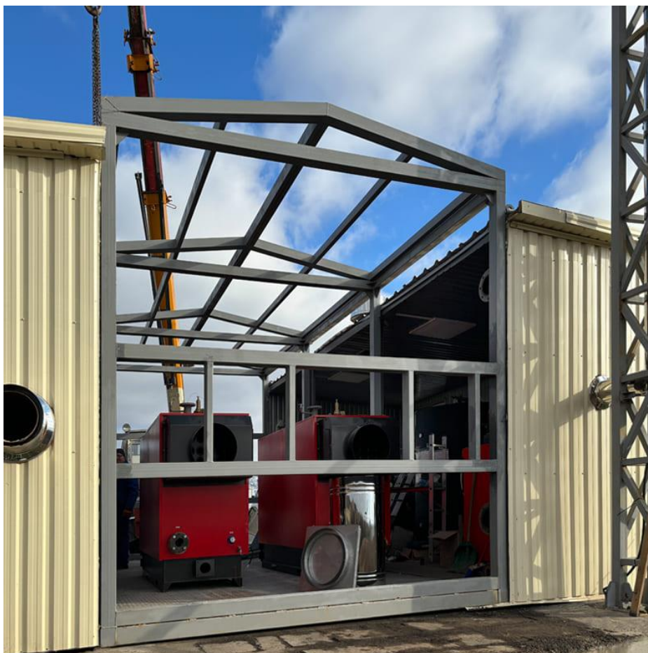
Рис. 4.1 Металоконструкції твердопаливної транспортабельної котельні в с. Осолінка, Вінницької області.
