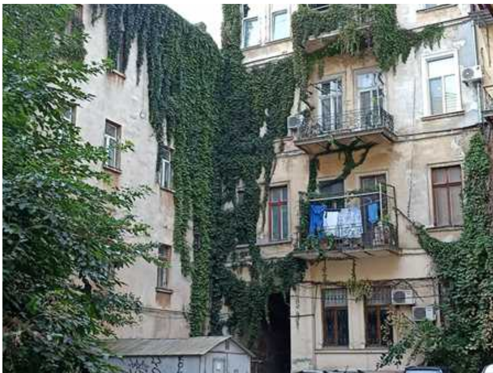
Рис. 4.13. Маскування недоліків будівлі вертикальним озелененням, м. Одеса (авторська світлина)
