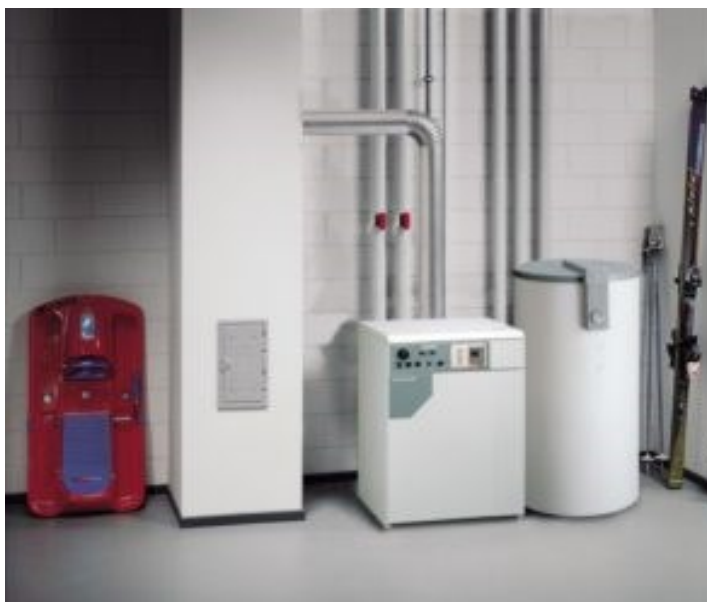
Рис. 7.1.2. Котельня в технічному приміщенні
