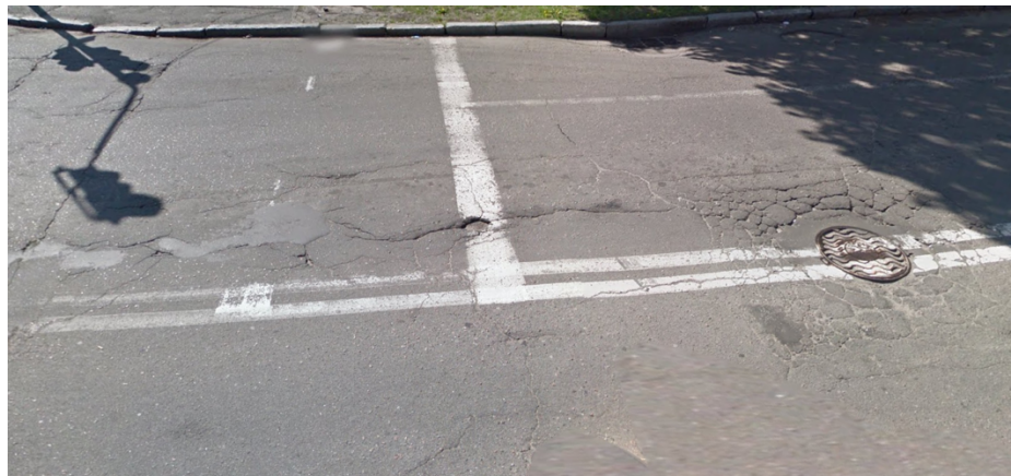
Рис 1. 3 – Фотофіксація стану дорожнього покриття на перетині вул. Ореста Левицького та вул. Мілютенка у м. Києві.
