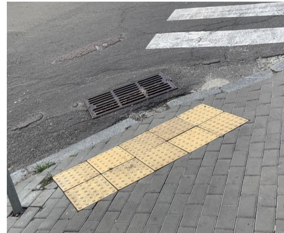
Приклад неправильного розміщення бетонної тактильної плитки
