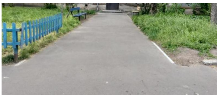
Рис. 5 Викривлене покриття тротуару, що веде до під'їзду
