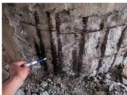
Рисунок 1. Бетонний контейнер системи зберігання - місця корозії арматури
