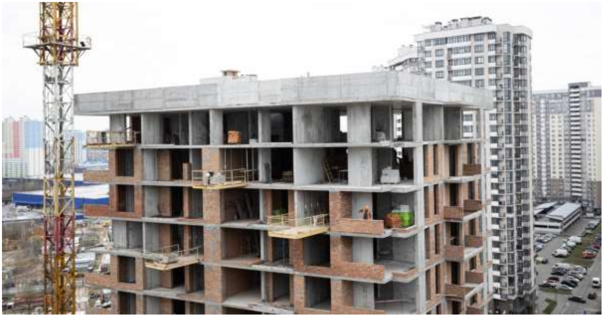
Рис. 2. Зведення монолітного залізобетонного каркасу ЖК «Krona Park II», Київська обл., м. Бровари, 2021.р. [8]
