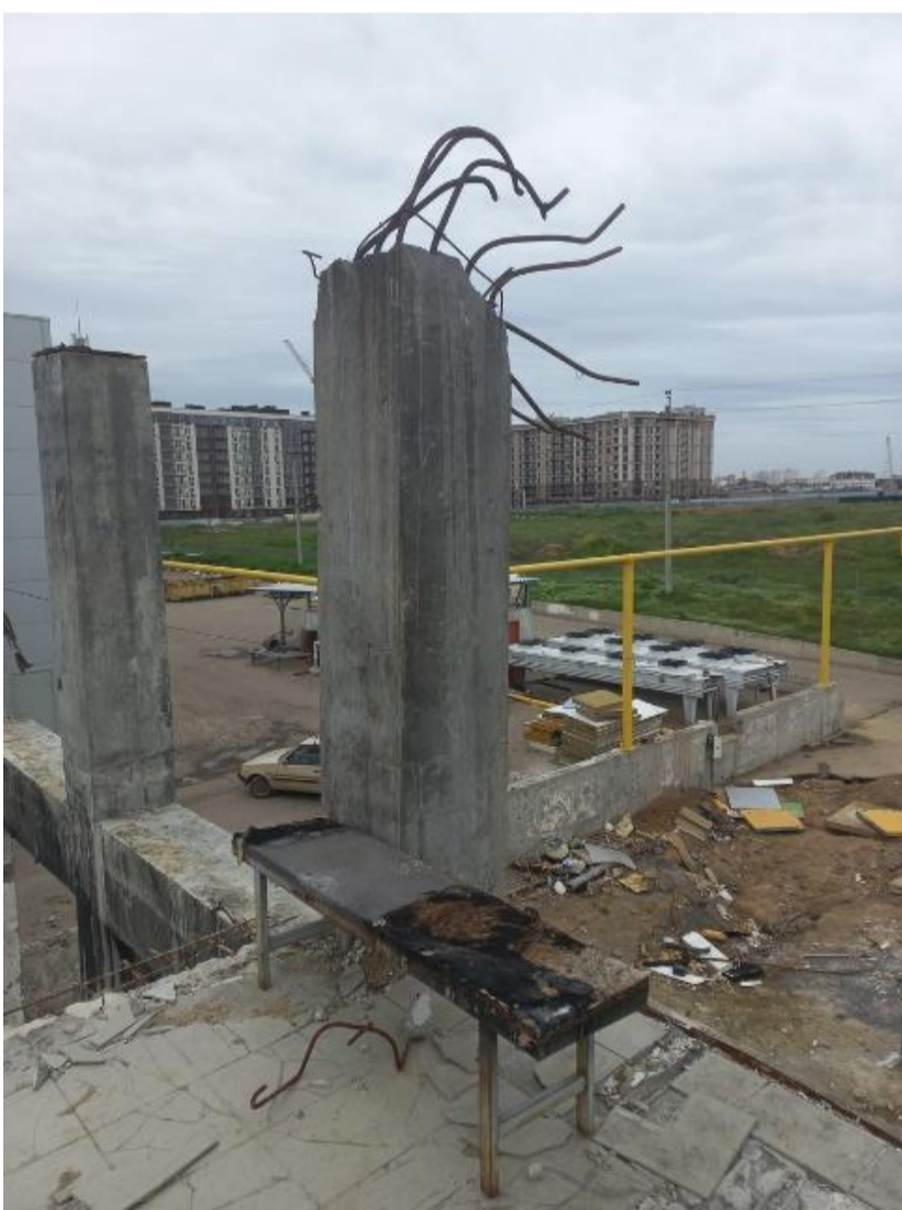
T8 – колона в осях Э/12 зруйнована внаслідок прямого втручання засобів ураження. Зруйнован оголовок та металеві опорні стійки під ферми. Арматура перебіта. захисний шар бетону відсутній на 2м
