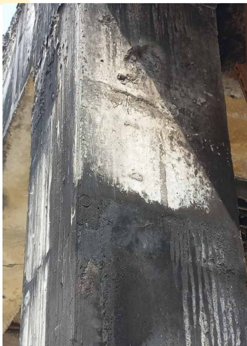
T1 - закопченість поверхні бетону по грані колон. Сліди копоті покривають більш ніж 60% поверхні грані колони
