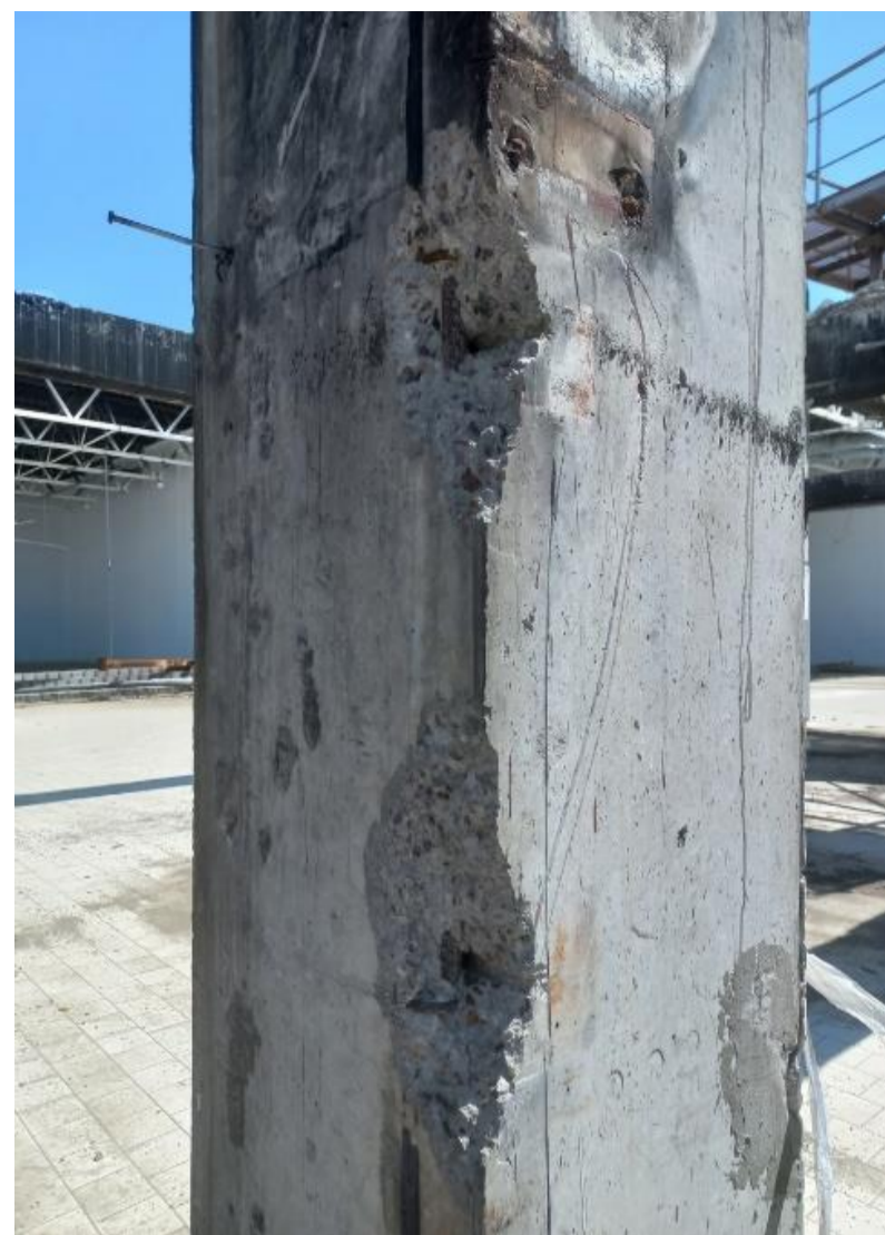
T4 -ділянки сколу захисного шару бетону по ребрам колон на глибину від 10мм до 200мм. Дефект характерен для 80% колон
