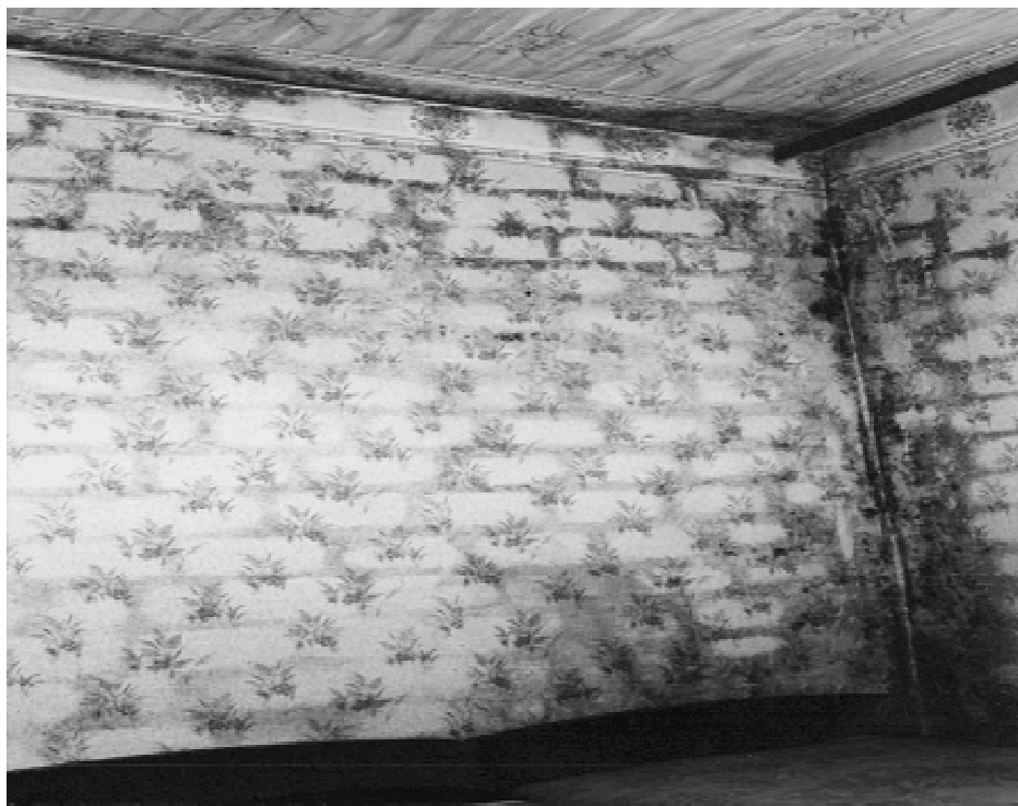
Рис.7 – Експлуатаційний стан конструкції з внутрішнім утепленням
