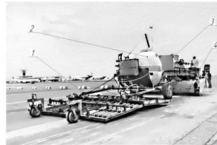
Зняття асфальто – бетонного покриття за допомогою спеціальної машини для гарячого фрезерування фірми WIRTGEN 1 – Газовий підгрівач асфальтного покриття; 2 – Газова ємність; 3 – Силовий агрегат; 4 – Фреза для гарячого фрезерування.
